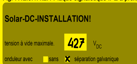
Fig. 7.12.5.1.4.2.4 Plaque signalétique IPE à proximité de l'onduleur ou posée sur ce dernier
